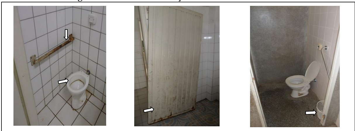
Figura 7 – Falta de manutenção em banheiros acessíveis
