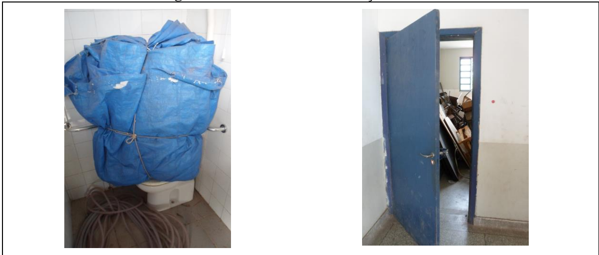
Figura 8 – Banheiros sem condições de uso
