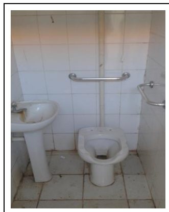
Figura 4 – Banheiro com dimensões e lavatório posicionados de modo inadequado para utilização de alunos usuários de cadeira de rodas.
