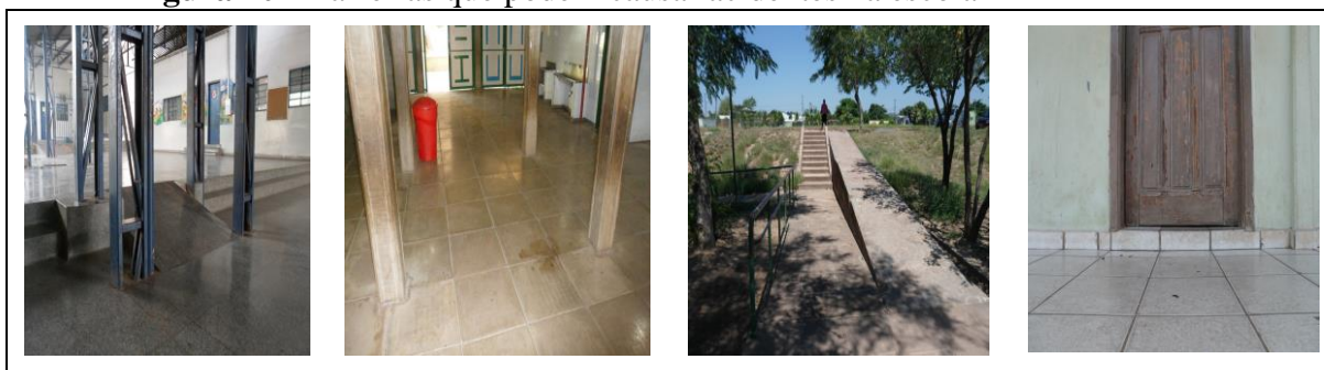
Figura 20 - Barreiras que podem causar acidentes na escola
